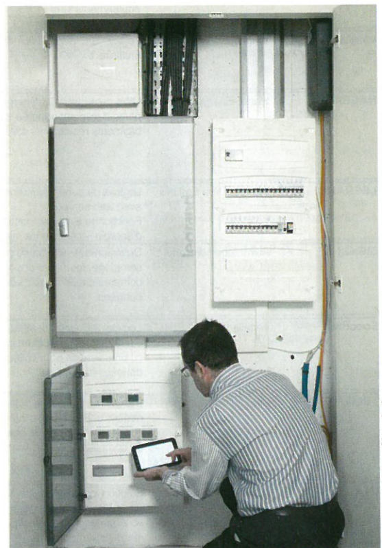
Exemple d'une armoire divisionnaire avec compteurs.
